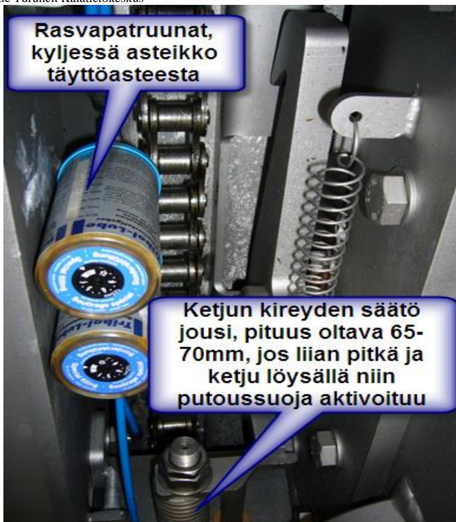
Kuva kaatolaitteen ketjusuojan takaa
