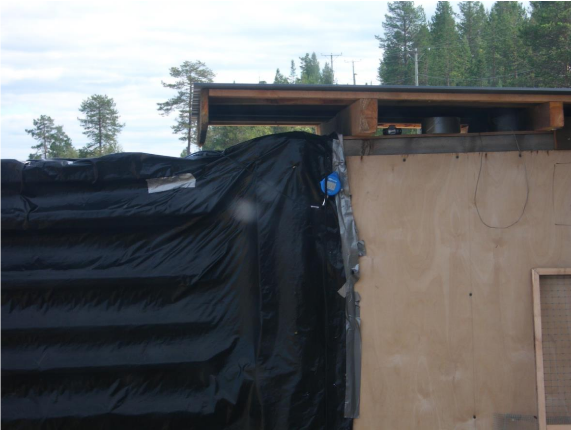
Kuva 2. Lokan kuivauskoppi ja siihen kiinnitetty pressu kuivaustuulettimen päällä ollessa kesällä 2012.
