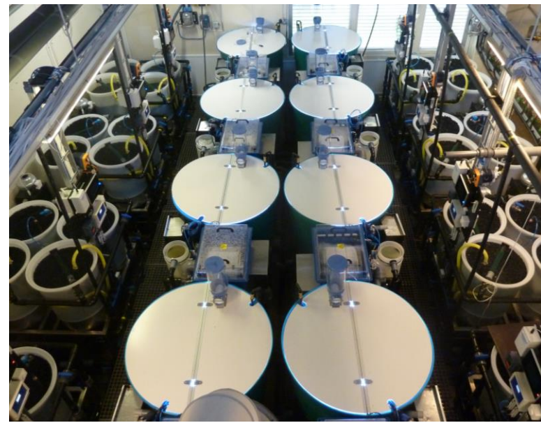
Laukaan koelaitoksen kiertovesijärjestelmä Kuva: Tapio Kiuru
